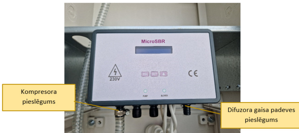
13.attēls. AQUABLOC VIRO bioloģiskās attīrīšanas iekārtas MicroSBR vadības bloks.
